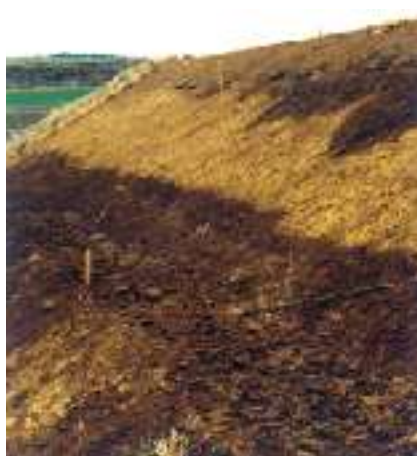
埋設カルドレーンからの排水状況
