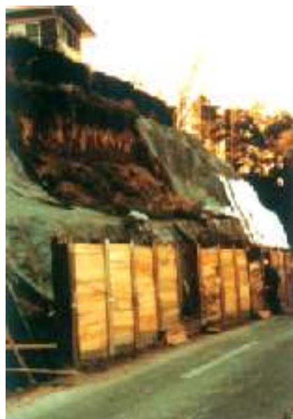
崩壊した急斜面の現場
