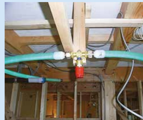
スプリンクラーヘッド取付部
